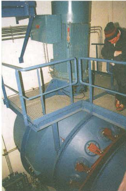
Wasserkraftturbine mit Stromgenerator
